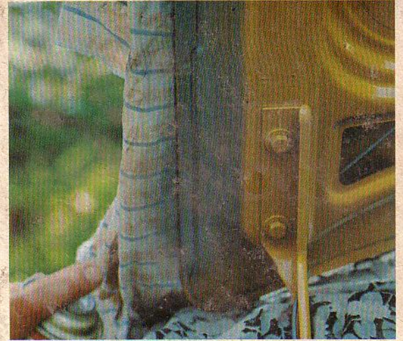
4. Vikta plåtkanter är ofta rostställen. Gör enligt 1 och 2.
